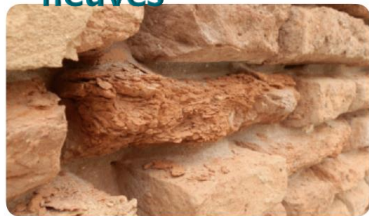
Brique effritée, inapte au réemploi
